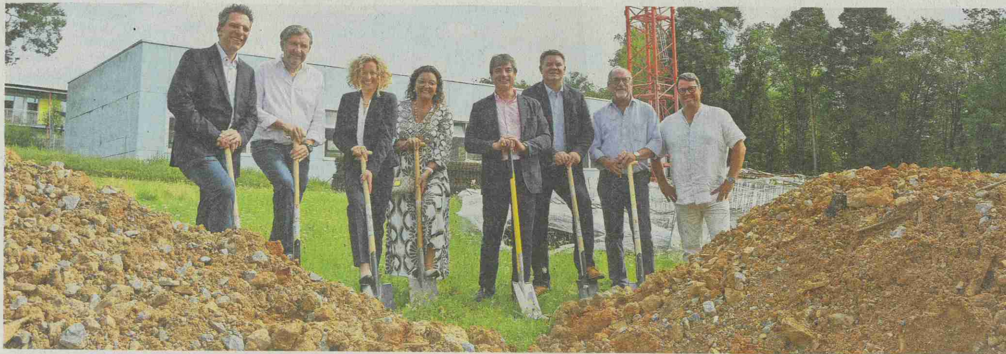
Beim Spatenstich: Die Dentaaurum-Geschäftsführer Ralph Dittes mit Architekt Frank Morlock sowie Claudia Stöhrle, Petra Pace, Mark S. Pace, Ispringens Bürgermeister Thomas Zeilmeier, John-Marco Fader (Dentaaurum) und René Talmon (Baufirma Heinrich Ross).
